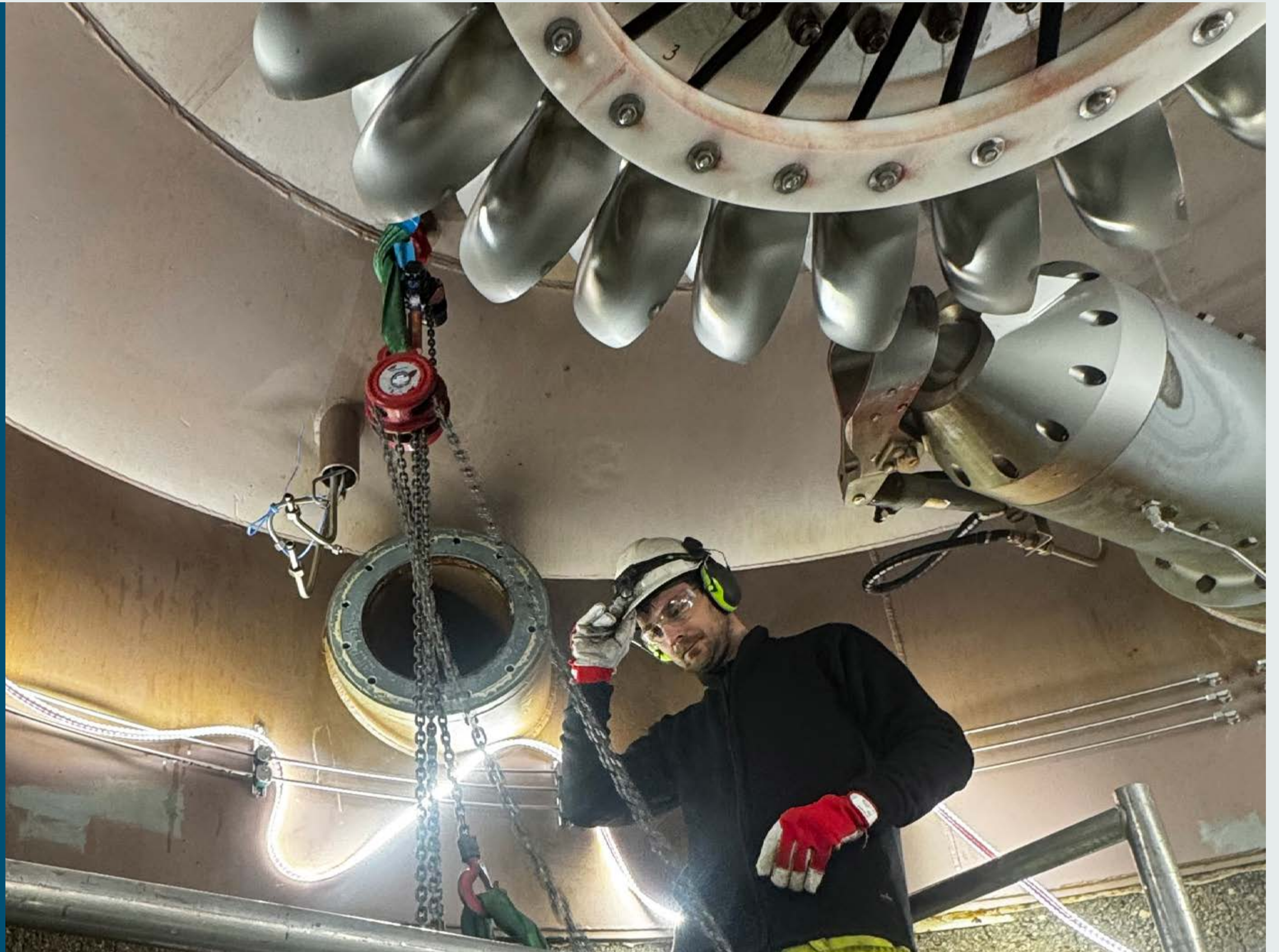
Utskifting av ei dyse på turbinen i Tverrelva kraftverk i Kvinnherad kommune.
